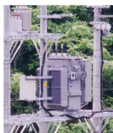
6.6 kV - 300 kVA級 系統電圧安定化装置
