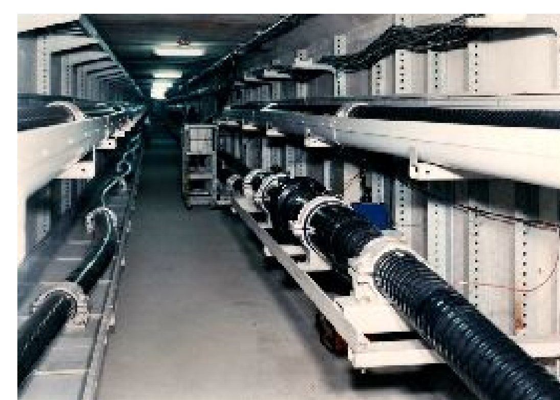
CVケーブルの外観と布設形態
