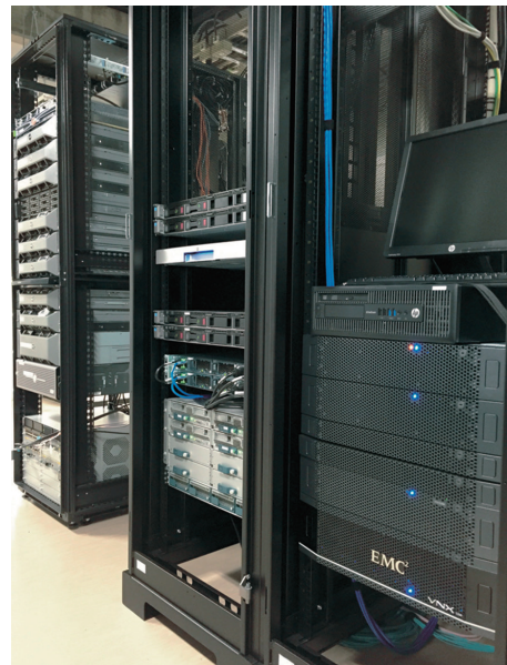
情報機器室 Server Room
