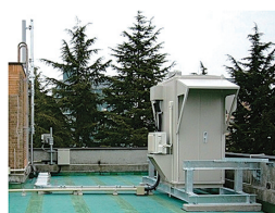
Fig. 3 MBWA 実証実験 (基地局設備) Fig. 3 MBWA field test (Base station)
