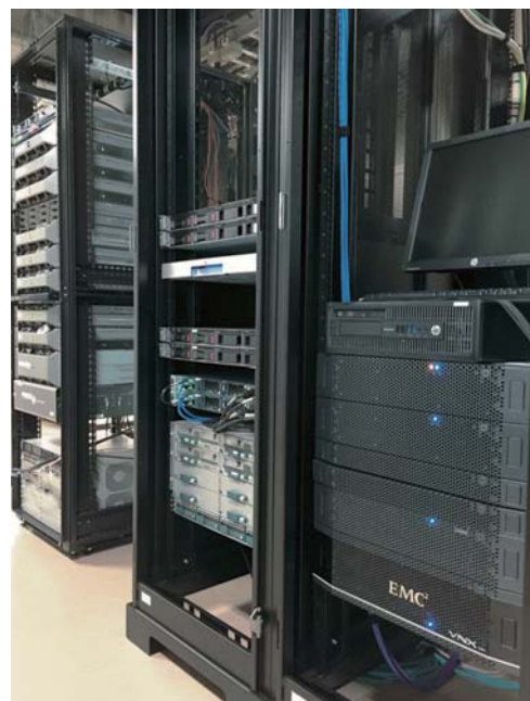
情報機器室 Server Room
