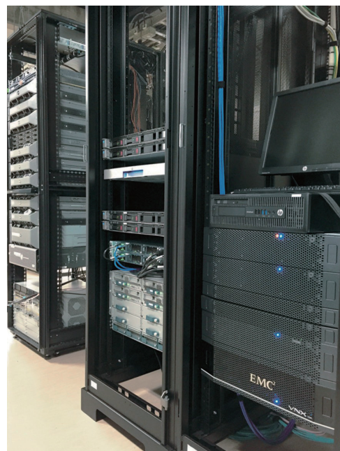
情報機器室 Server Room
