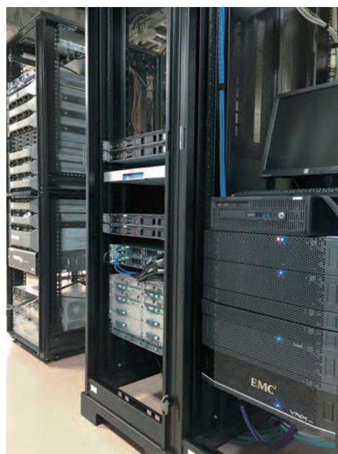
情報機器室 Server Room
